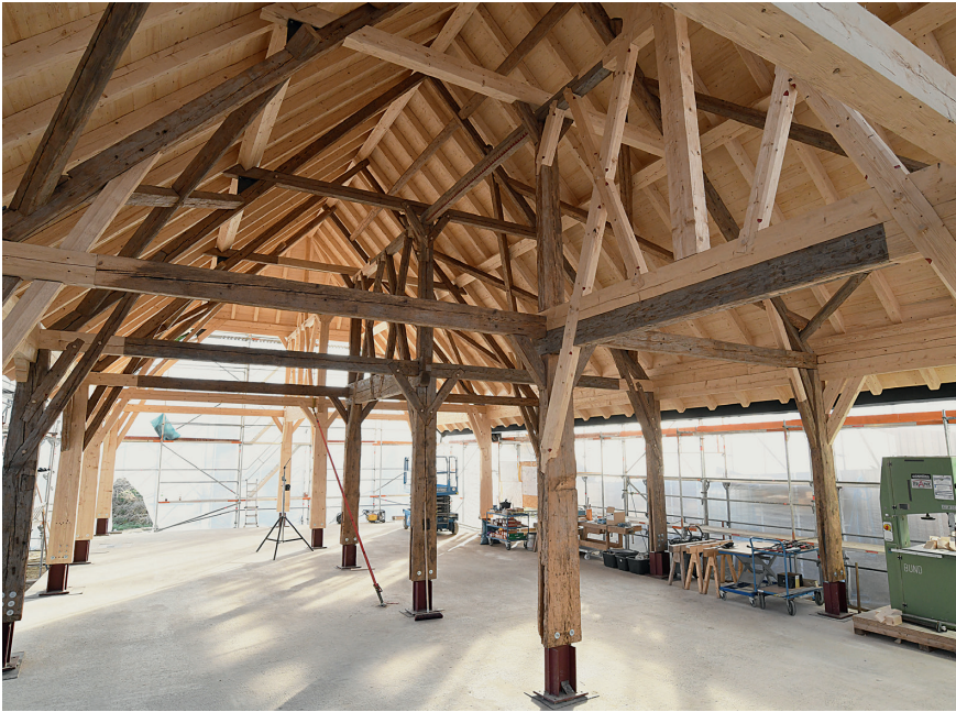
Die Tragwerkskonstruktion des Marzlinger Barockstadels. Die verrotteten Fußpunkte der Stützen wurden gesundgeschnitten und mit Füßen aus Stahl ergänzt.
